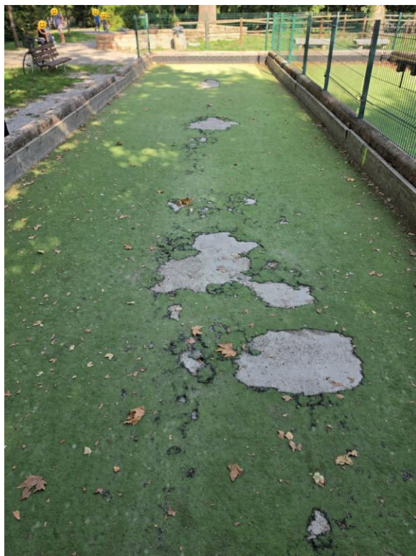
Foto 4 - Vista d'insieme del campo di sinistra che risulta maggiormente deteriorato e mancante della spondina laterale.
