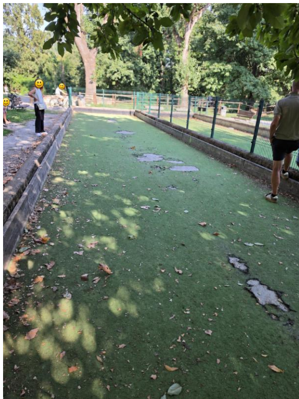
Foto 5 - Ulteriore vista del deterioramento del panno del campo di sinistra e del lato esterno.
