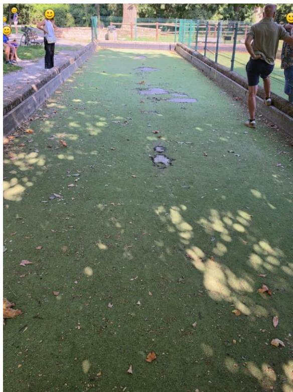
Foto 6 - Vista complessiva del campo di sinistra e delle porzioni di panno mancanti.
