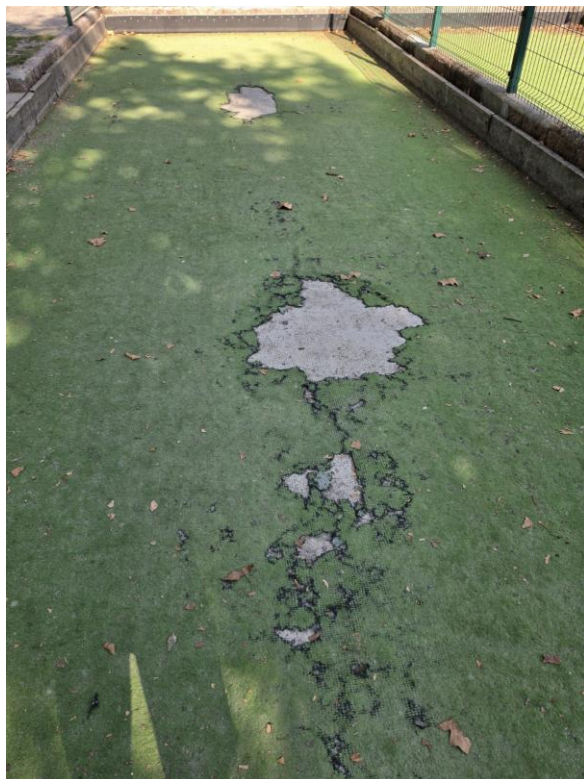
Foto 3 - Degrado esteso del panno lungo il piano di gioco del campo di sinistra.
